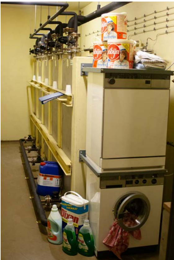
Beveiligde watertanks met wasmachine en droger, schok-beveiligd vastgemaakt, noodzetel ministerie van Buitenlandse Zaken, Den Haag
