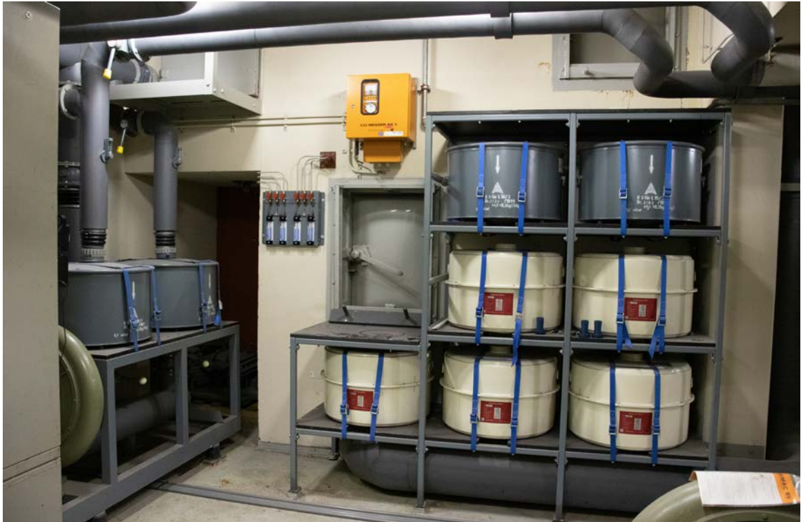
Luchtfilterinstallatie en opslag actief koolfilter (R3, grijze bus) en witte CO 2 -absorptiefilterbussen (K3). Oranje object is een later geïnstalleerde CO-meet- en alarmsysteem, noodzetel KNMI De Bilt
