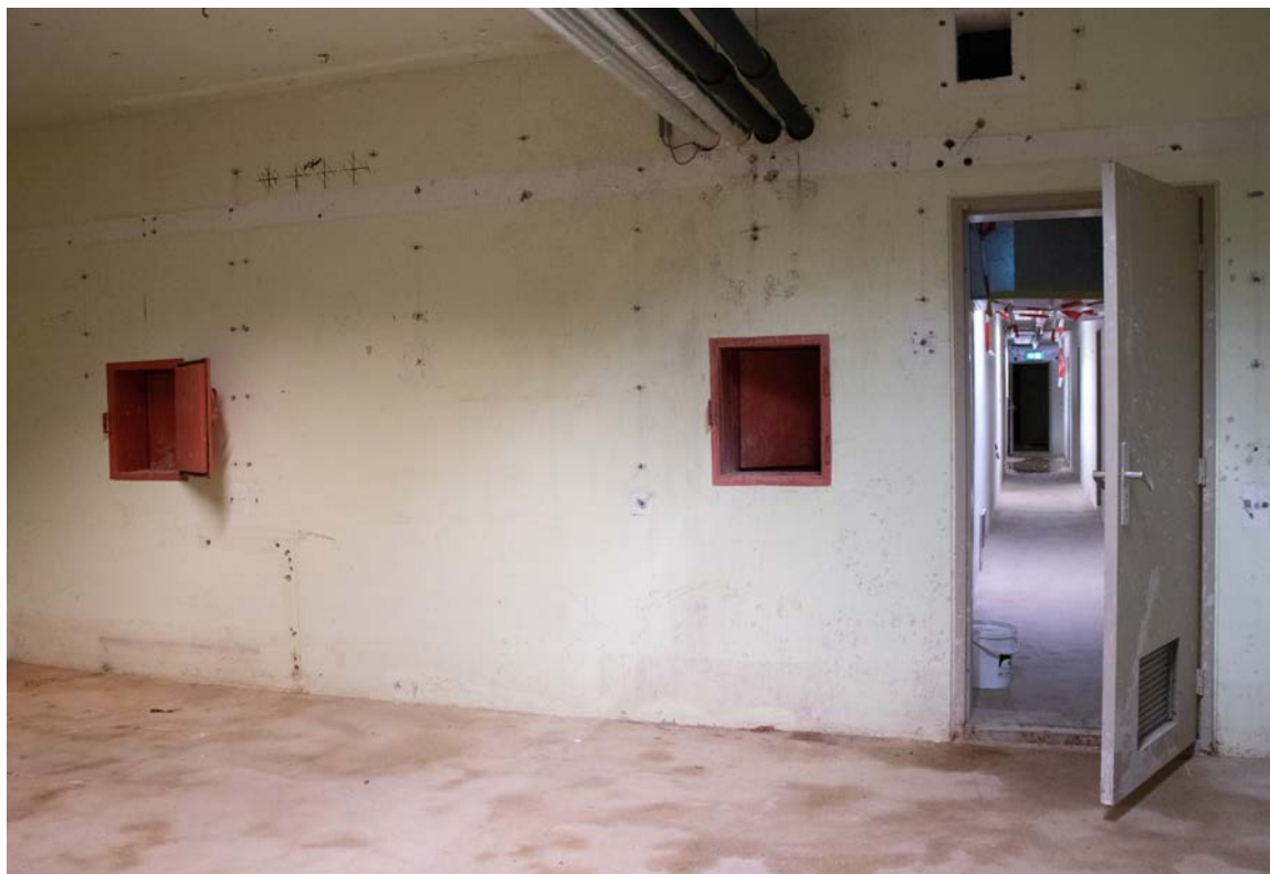
Plotkamer en stafkamer met doorgeefluikjes naar verbindingcentrum in de noodzetel ministerie van Landbouw en Visserij in Tilburg
