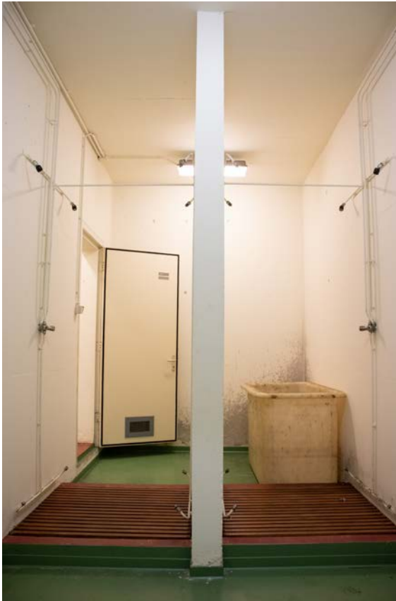
De tweede ruimte met ontsmettingsdouches in noodzetel KNMI, De Bilt
