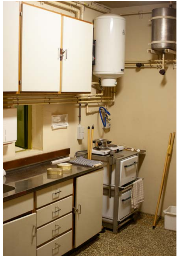
Kombuis met ovens in de noodzetel van het ministerie van Verkeer en Waterstaat, Delfzijl
