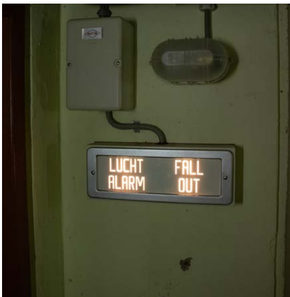
In elke hoek van de gang van een noodzetel hing een lichtbordje aan de muur waarop werd aangegeven wat de dreiging buiten was: luchtalarm of fall-out. Dit is de noodzetel in Middelburg
