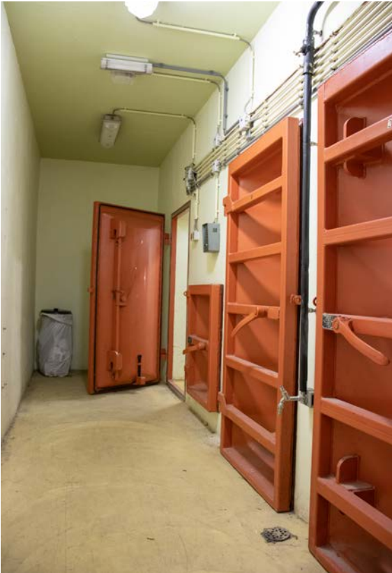
Ingang en sluis van de noodzetel ministerie van Verkeer en Waterstaat in Middelburg
