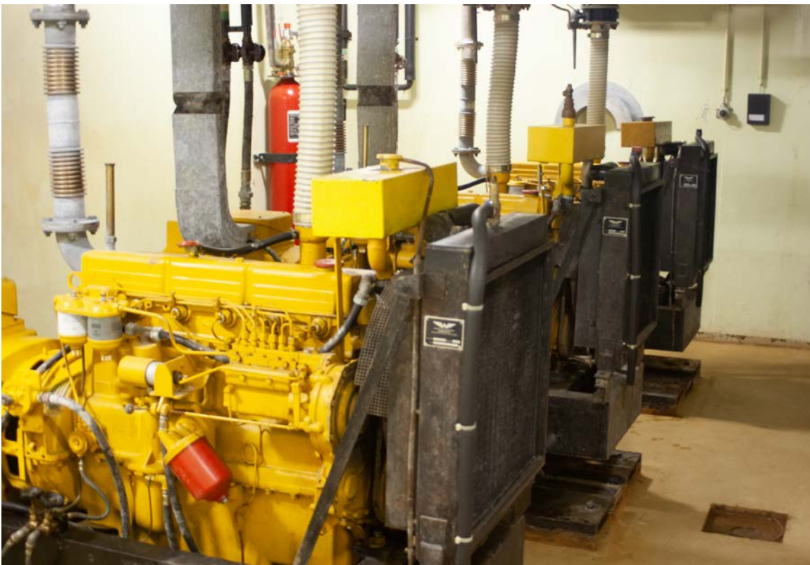
Noodstroomgeneratoren in de noodzetel van het ministerie van Binnenlandse Zaken en Justitie, Den Haag
