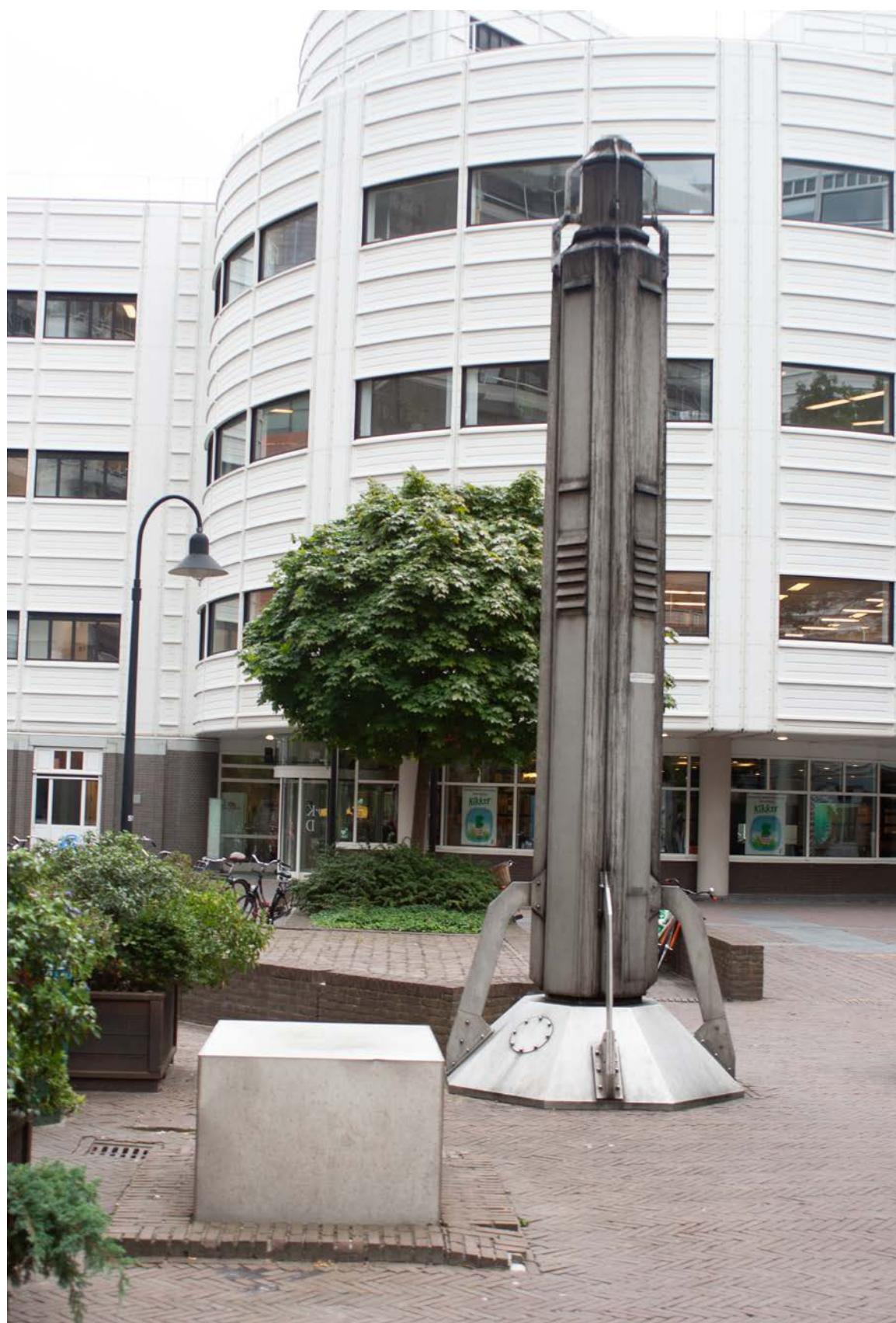
Luchtuitlaat, -inlaat en ijzeren doos voor koelwaterput bij de noodzetel onder het ministerie van Buitenlandse Zaken, Den Haag. Net een kunstwerk. De architect had verschillende maquettes van deze luchtuitlaat gemaakt
