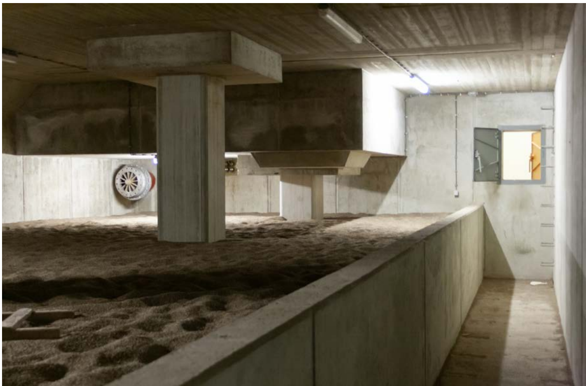
Zandfiltrerruimte in NCO-ruimte in de noodzetel van Staatsbedrijf de PTT op de Louise Henriëttestraat te Den Haag
