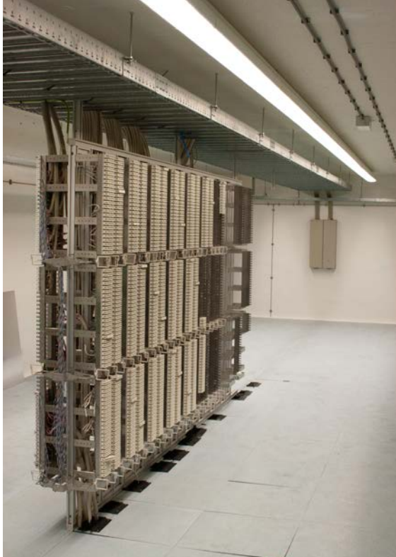
Ruimte voor de voormalige telegraaf- en handcentrale in de PTT NCO-ruimte op de Louise Henriëttestraat te Den Haag
